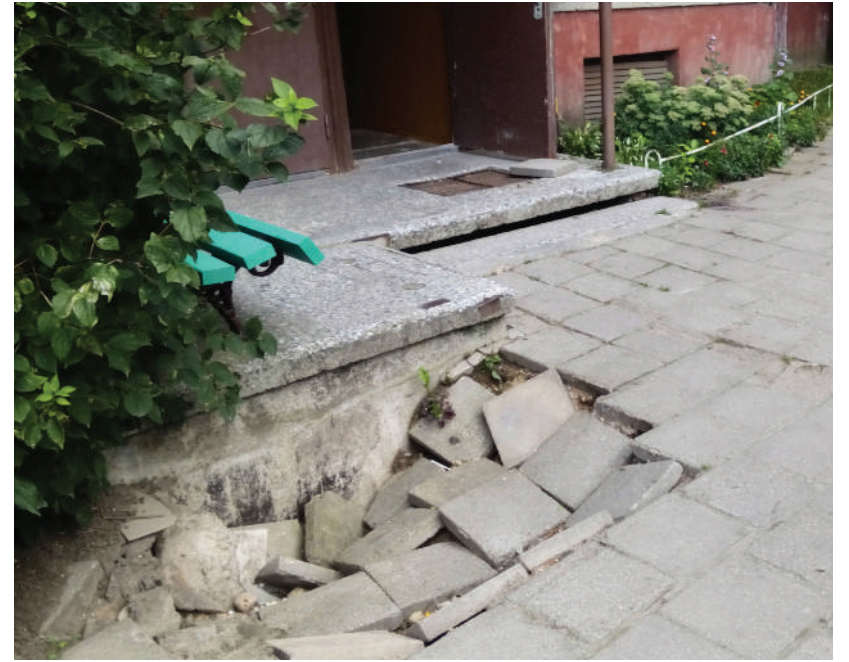
Pagrindinis įgriuvos kaltininkas yra drenažo sistema – trūkęs vamzdis
