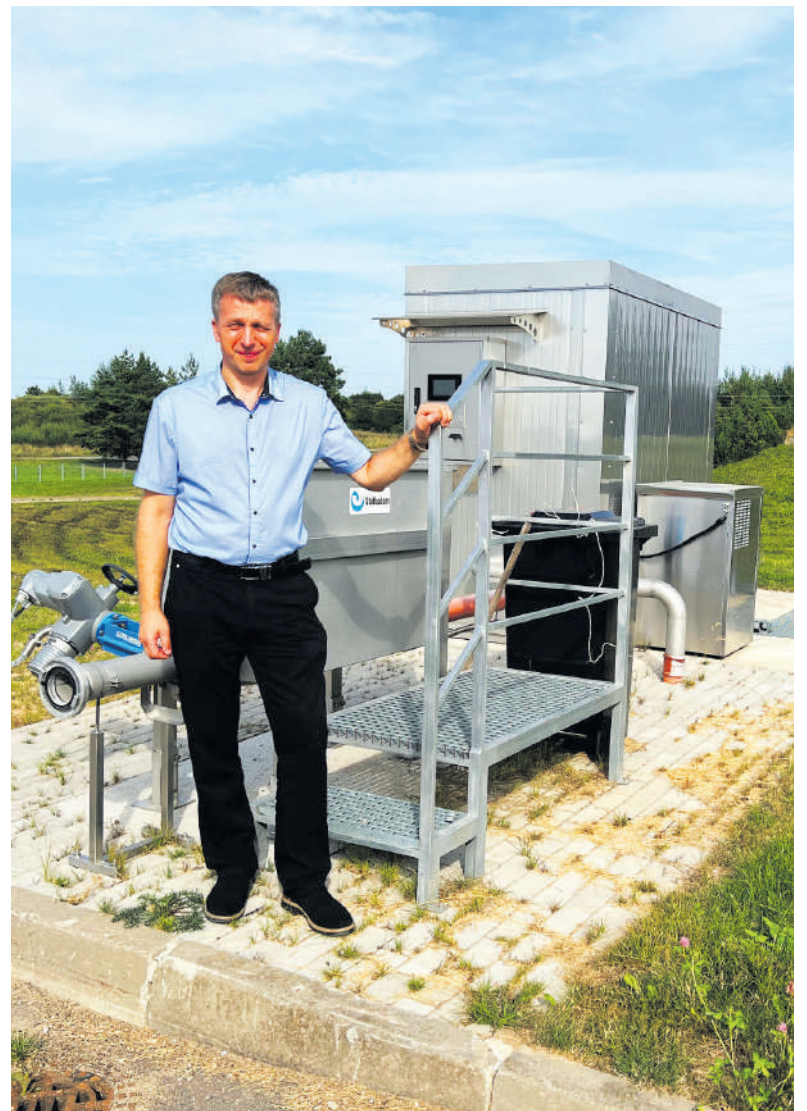
„Rokiškio vandenys“ direktoriaus L. Butėno teigimu, po rekonstrukcijos pagerėjo išleidžiamo išvalyto nuotekų vandens kokybė. („Rokiškio Sirenos“ nuotr.)
