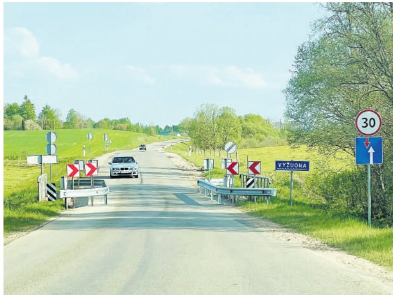
Dėl prastos būklės susiaurintas tiltas per Vyžuoną. („Rokiškio Sirena“ nuotr.)
